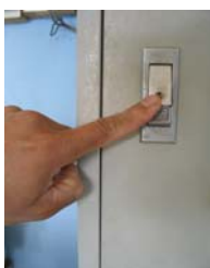
รูปที่ 10 ปุ่มล๊อคฝาตู้ควบคุมเครื่องสูบน้ำดิบ
