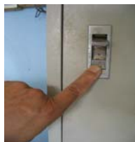
รูปที่ 8 ปุ่มล๊อคฝาตู้ควบคุมเครื่องสูบน้ำ
