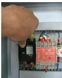
รูปที่ 55 ดันเบรกเกอร์ ที่ตู้ควบคุมไปที่ตำแหน่ง “ON” หรือ “เปิด”
