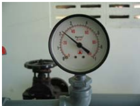
รูปที่ 52 เข็มของเกจวัดแรงดัน จะแสดงการทำงานของเครื่องสูบน้ำดี
